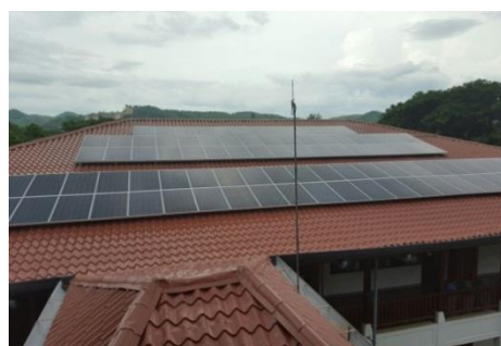
Paneles solares en campus de la UNA
