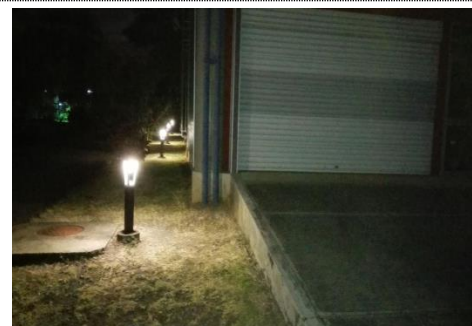
Iluminación LED en zonas verdes de la UNA
