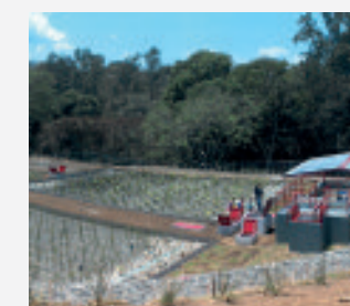
Sistema de tratamiento de aguas residuales, Escuela de Medicina Veterinaria, Campus Benjamín Núñez
