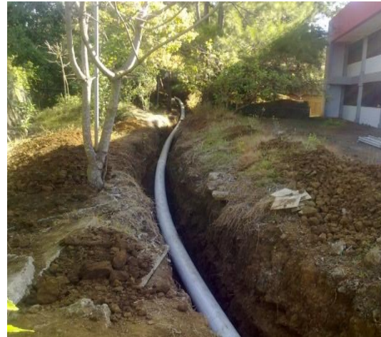
Canalización aguas negras Foto: Área de Planeamiento Espacial
