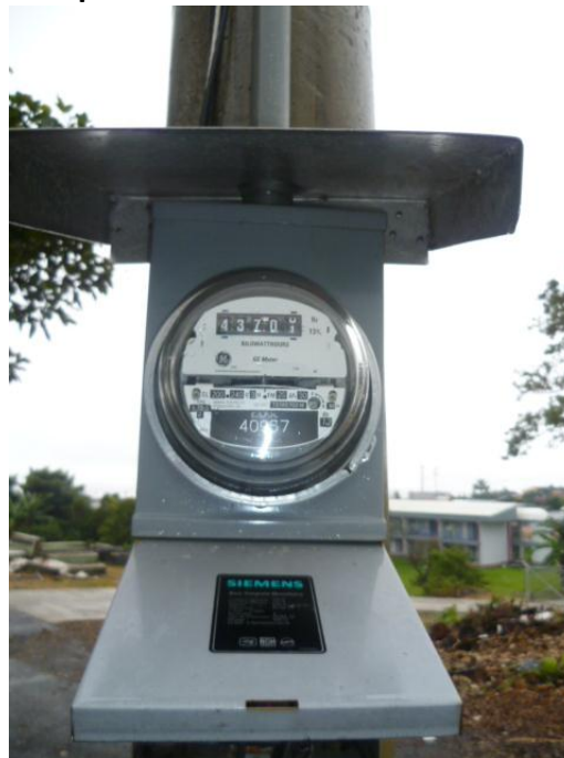
Medidor de energía eléctrica
