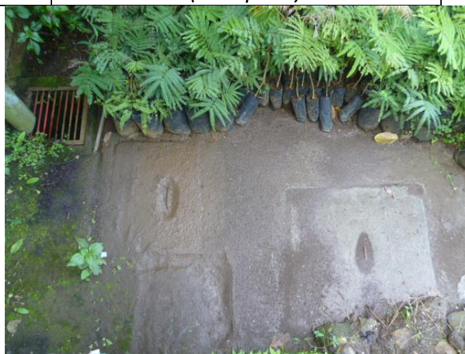
Tanque séptico de tratamiento de aguas residuales
