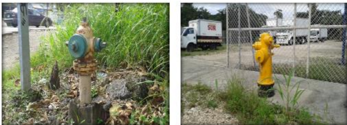
Figura 33. Fotografías de dispositivos para la atención de incendios existentes en varios puntos del “Campus Nicoya”. Fuente: Geocad, 2015.
