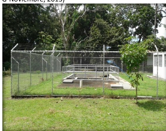
Fotografía 9.14. Planta de tratamiento de aguas negras existente en el “Campus Liberia” (MAPG-Noviembre, 2013)
