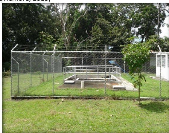
Fotografía 5.11. Planta de tratamiento de aguas negras existente en el “Campus Liberia” (MAPG-Noviembre, 2013)
