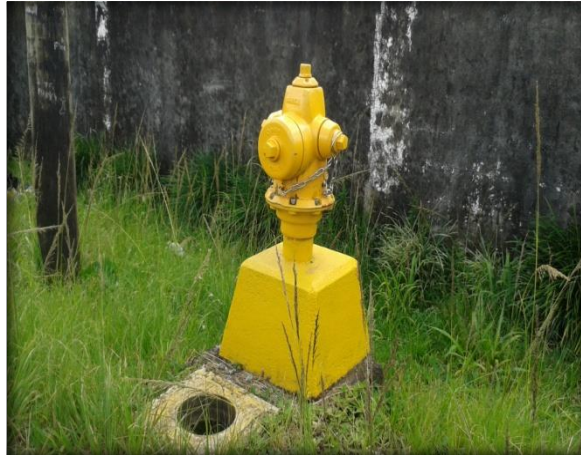
Fotografía 5.5. Dispositivo para la atención de incendios existente en las afueras del “Campus Pérez Zeledón” (MAPG-Noviembre, 2013)
