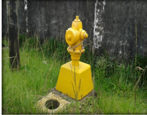
Fotografía 9.9. Dispositivo para la atención de incendios existente en las afueras del “Campus Pérez Zeledón” (MAPG-Noviembre, 2013)
