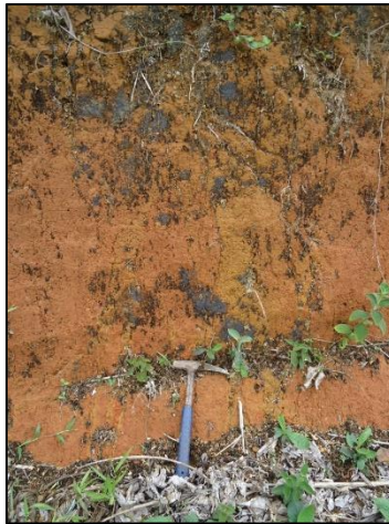
Fotografía N° 2. Condiciones del suelo en el AP, su textura es media a fina, de color rojizo. Se correlaciona con la Formación El General.
