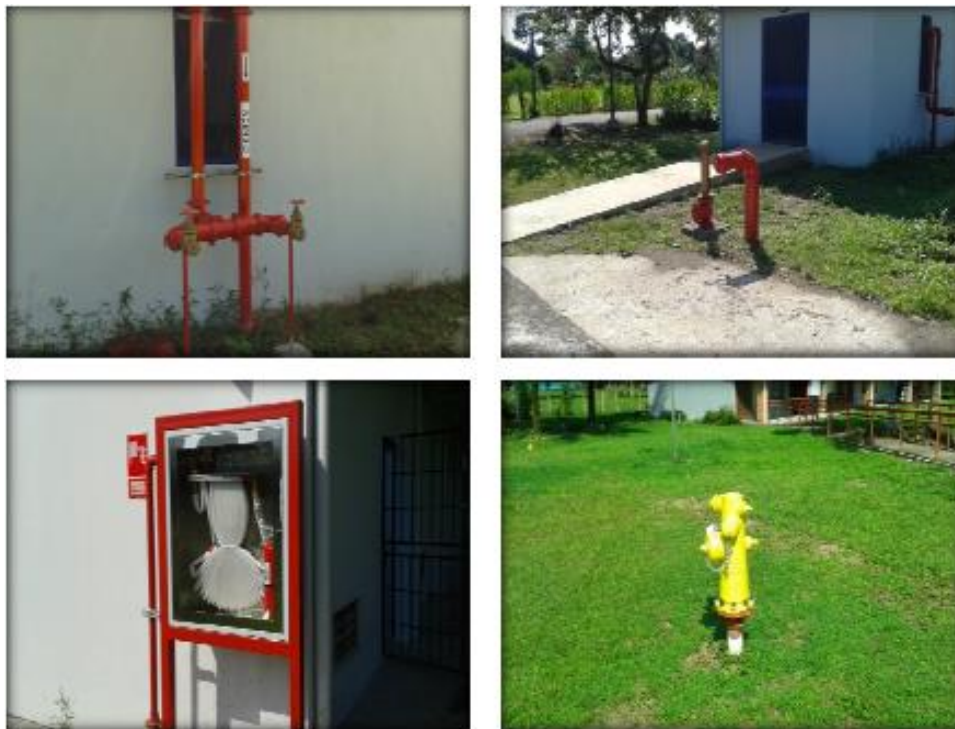
Figura 22. Fotografías de dispositivos para la atención de incendios existentes en varios puntos del Campus Sarapiquí. Fuente: Geocad, 2015.
